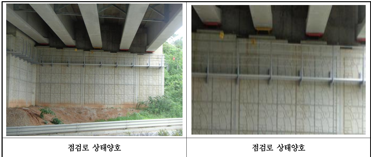
【사진 40.3.26】 교량 점검시설 손상현황
